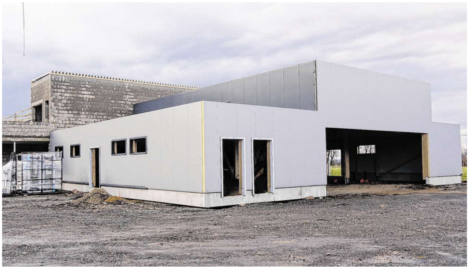
Hier entsteht die neue Heimat des TSV Kesternich: Am Ortsrand auf der Kesternicher Höhe wird zurzeit fleißig gebaut. Die Konturen des neuen Sportzentrums sind bereits mehr als deutlich zu erkennen. Foto: Max Stollenwerk
